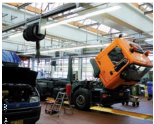
Bild rechts: Saugschlitzkanal-Anlage in der Lkw - Werkstatt
